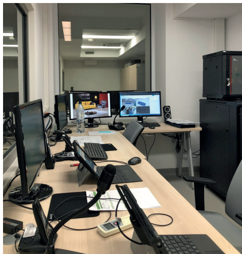
Fot. 4. Sterownia techniczna
